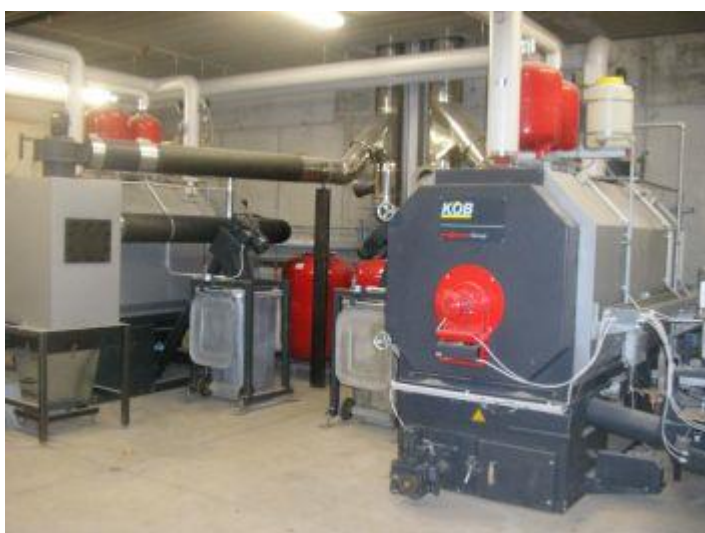
Figura 2 Vista interna della centrale
